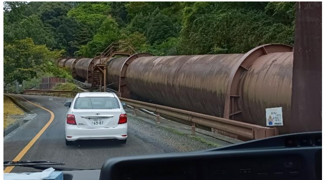
図8 水が通る巨大なパイプ
